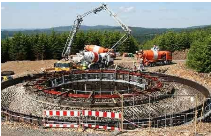
Das Fundament einer Riesen-Windkraftanlage im Verhältnis zu einem ca. 7 m langen Betonmischer
